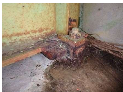
支承に腐食が見られます
