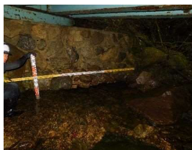
下部工に洗掘が見られます。
