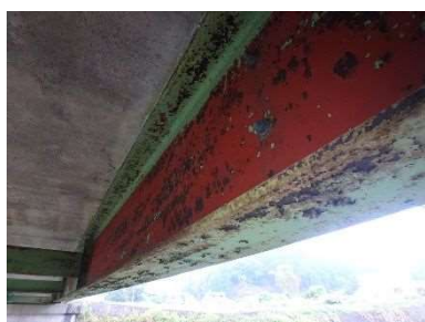
鋼桁に腐食が見られます
