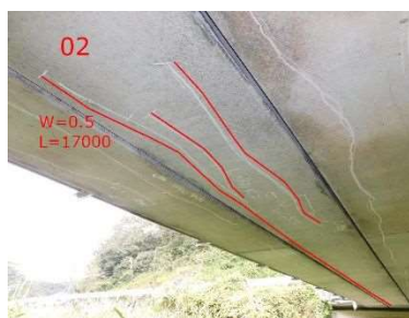
コンクリートの桁にひび割れが見られます。
