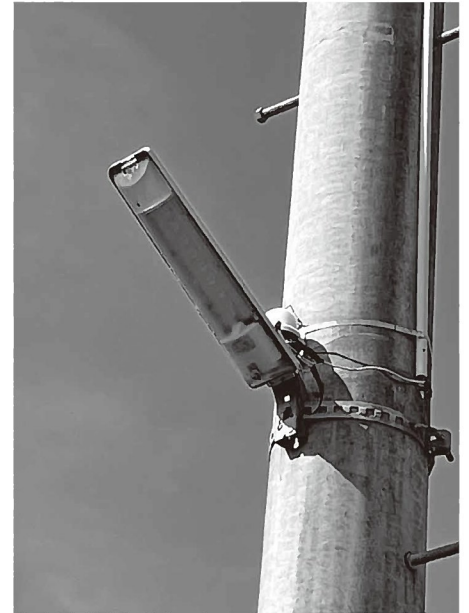
市内のLED道路照明
