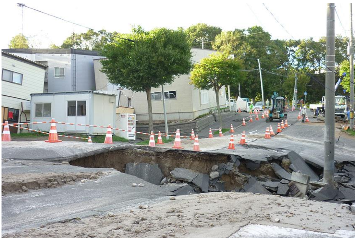
図 3-1-1 地震の被害により道路が崩壊している様子（北海道札幌市）
